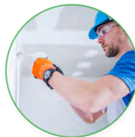
Instalación y puesta en marcha
